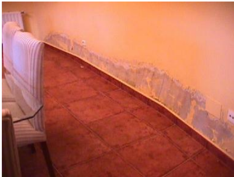
Humedades en Comedor
